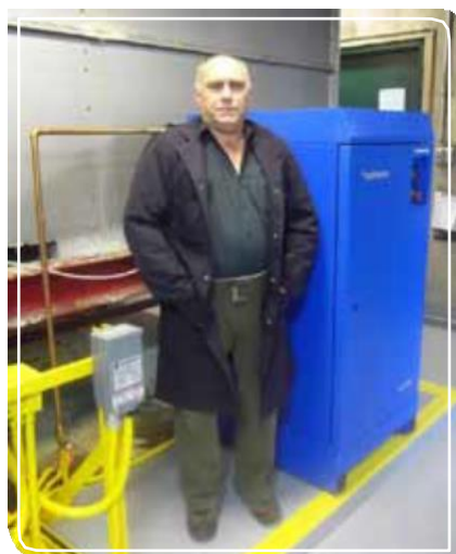
Jeff McCulloch P.E., operator budynku, Berezan Management (Alta) Ltd., przy sprężarce HV11RS
